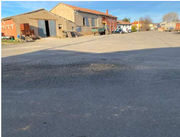
1.-Deterioro pavimento en acceso principal
