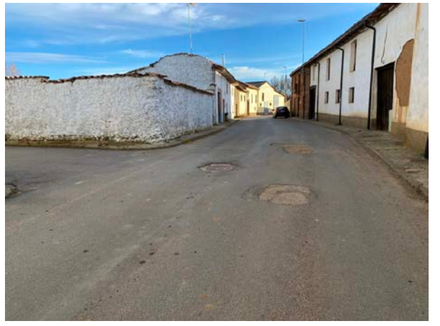
10.-Deterioros en el pavimento
