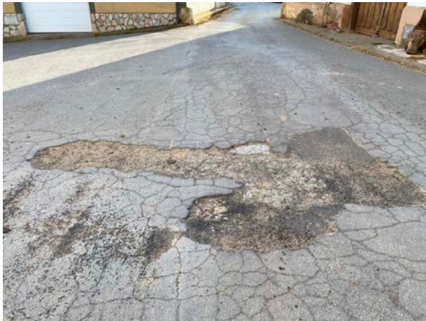
11.-Daños existentes en el pavimento
