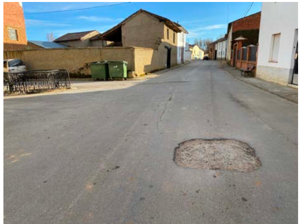
8.-Deterioro de pavimento aglomerado
